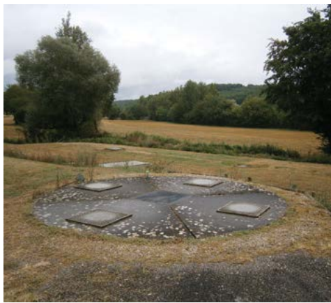
/ Bardigues – station à filtres à sable
