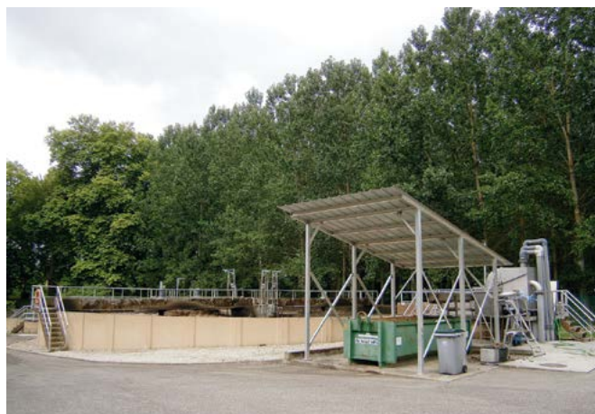
/ Station à boues activées à Valence d'Agen
